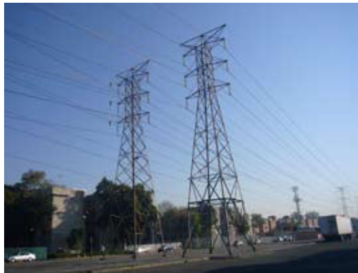
Torre de electricidad
